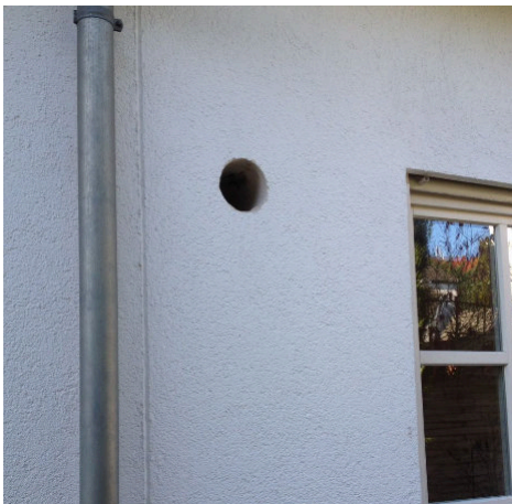
Sauberes Loch an Außenwand
